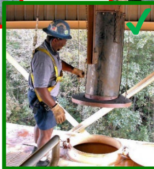
Extremo derecho: Seguro - Eslingas dobles de amarre cuando se trabaja y moverse en altura
