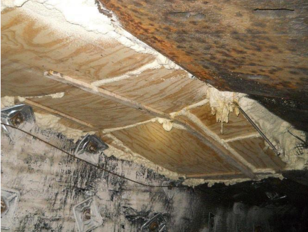
Aplicación incorrecta de un producto de espuma a base de poliuretano que rellena un vacío de gran volumen.
